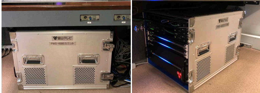
中継車の操作卓下に設置されたPWS-4500。可搬型のケースに収まっているため、持ち出しでの運用も可能。
