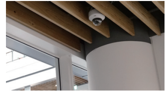
事務棟にも防犯用のカメラを設置
