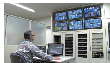
合計約70台のカメラでスタジアム内外の安全を見守る
