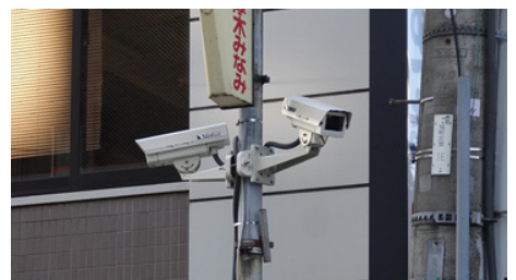
見守りカメラとして5ヶ所12台のカメラを設置
