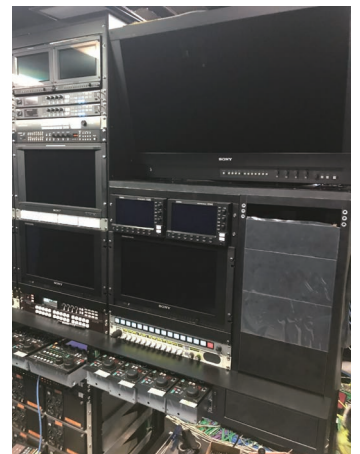
車内で設置・調整中のBVM-HX310
