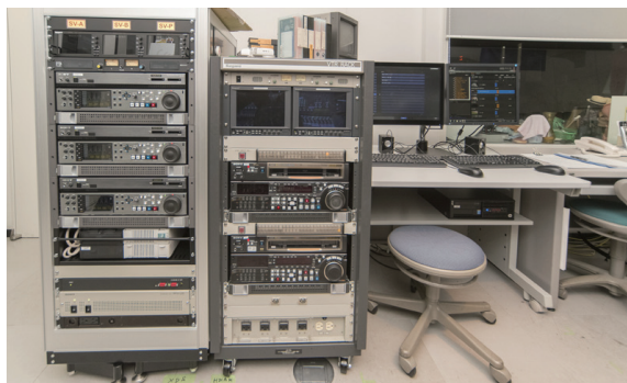
報道サブ内の3式の送出用XDCAM Station XDS-1000(左ラック)と、XDS-1000へのファイル転送の制御を行うPC端末(右)。報道サブはXDCAM Stationの導入を除いてシステム変更を行わなかったことで、スムーズで混雑のない移行を実現しました。
