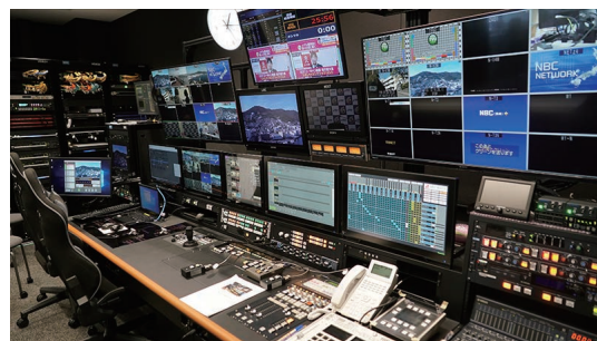
報道サブに設置されたOTCシステム
