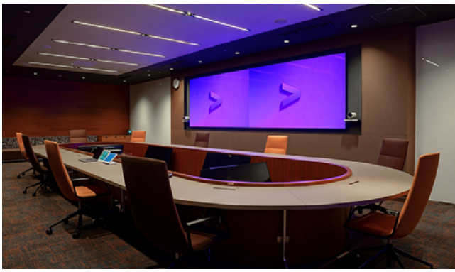
資料の見やすさが重視される AIR のボードルームに設置された Crystal LED
